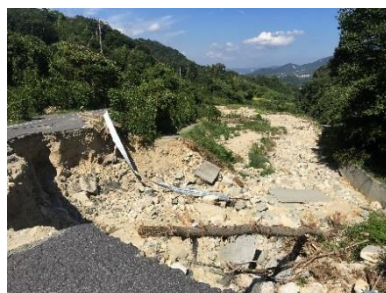
土砂災害で崩壊した道路
