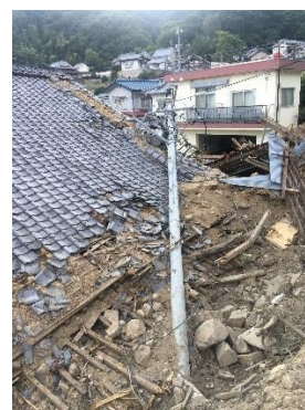
土砂で倒れた電柱
