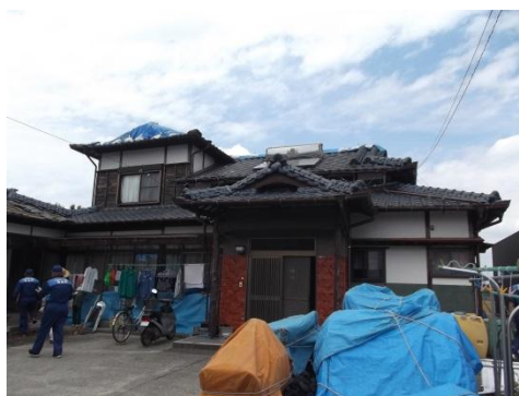
写真 3 家屋被害調査
