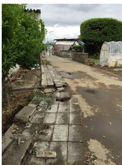
転倒したブロック塀
