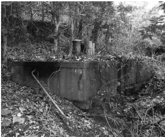
長浜水揚場に残る東瀛荘に給水した水道タンク (増設されたようで当時よりは規模が大きくなっている。)
