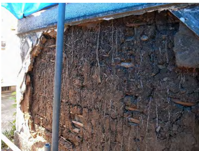
写真 3-4-2-2 平成 21 年地震による東土蔵海鼠壁の崩落
