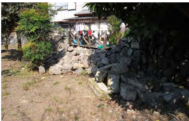
写真 3-4-2-1 平成 21 年地震による東側石垣の倒壊
