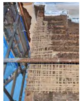
後世の下地補修
