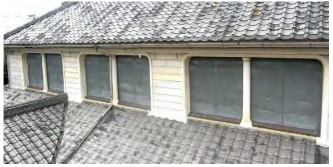
写真 4-4-4-7 2階南面窓廻り（修理前）
