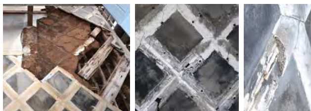
北土蔵木摺下地・接着土 北土蔵海鼠瓦 文庫蔵モルタル 写真 4-4-4-30 海鼠壁後世補修痕
