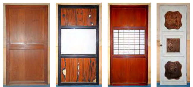
ヒロマ[18] ナカノマ[10] ナカノマ[9] 2階廊下[102] 写真4-4-5-4 主屋板戸各種（修理前）
