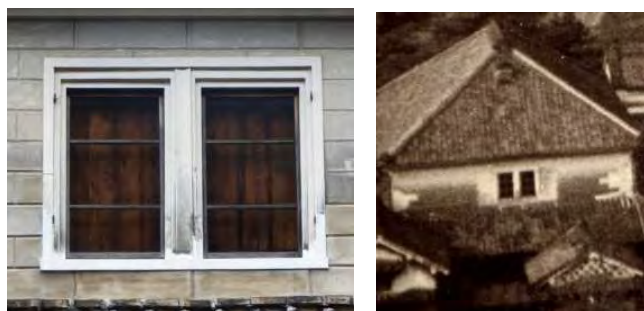
修理前の状態（鎧窓欠失）
