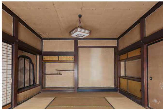
写真 4-4-9-4 ジョウダンノマ修理前状況
