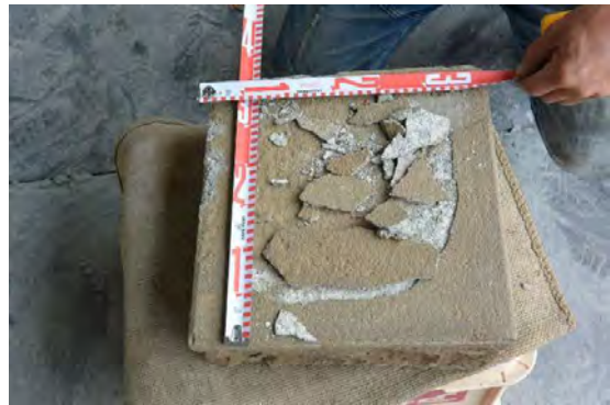
主組2 ワキゲンカン（踏込）敷石破損状況
