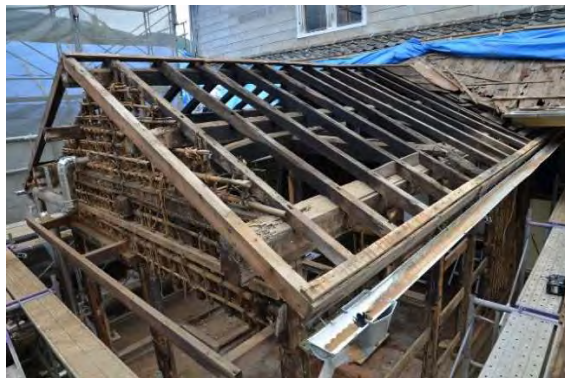
釜解12 垂木状況 越屋根が乗っていたと思われる中央付近の垂木は全て後補材であった。
