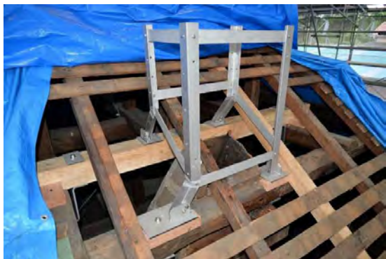
主組24 煙突補強ステンレス鋼材下地状況
