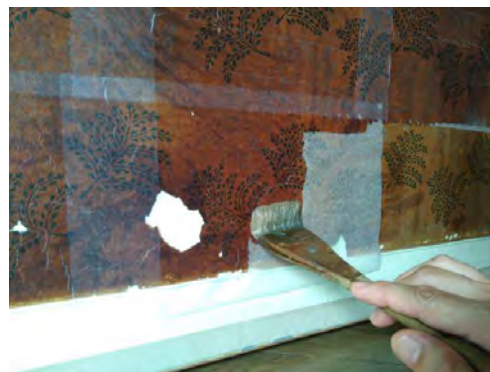
主組62 2階応接間襖剥落止め状況
