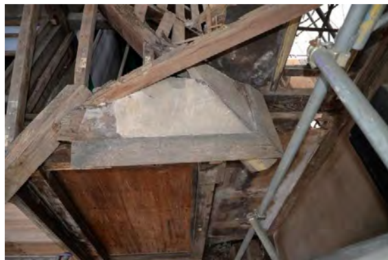
主解28 北下屋西端 当初広小舞残存状況 下屋で当初の広小舞が残っていたのは蔵前に組み込まれる北西隅のみ。
