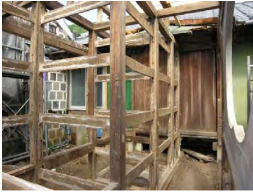
便解29 軸部状況
