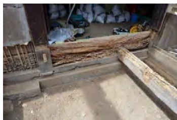
ミ解43 主屋・ミセ接続部 差敷居は改造で斫られた上に、蟻害を受けていた。
