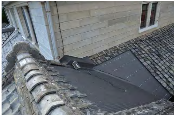
ミ解10 大屋根、主屋下屋取り合い現況 トタンは平成の応急修理。
