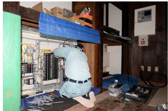
ミ組41 1階押入れ内 分電盤設置状況 電灯分電盤、防災監視盤等は管理事務所として使用されるミ セ1階に集約した。
