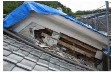
ミ解45 西妻面擬石塗下地状況 後世に下地からやり替えられていた。
