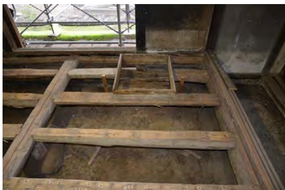
ミ解34 1階中古囲炉裏仮組確認 根太が1本切断され添束が挿入されていた。
