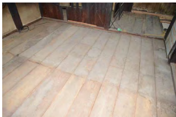
ミ解35 2階荒床板状況
