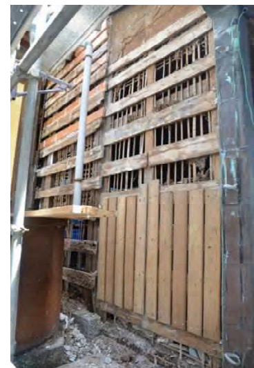
ミ解48 西面擬石塗下地状況
