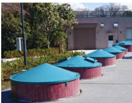
泉水源地 7本の深井戸
