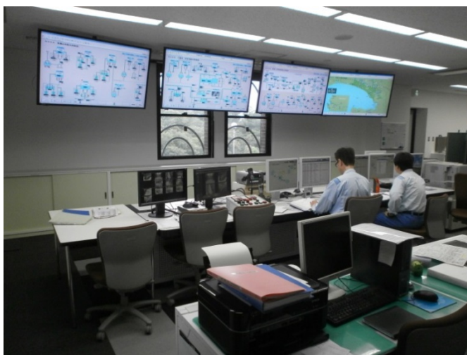
送水管理センター 中央管理制御室
