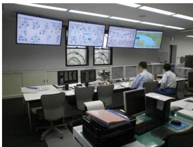
送水管理センター 中央管理制御室
