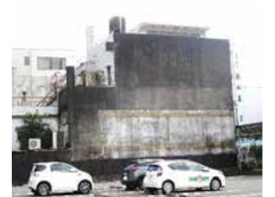
薄汚れたコンクリートの壁面
