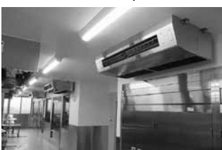
▲門池小学校調理場に設置されたエアコン
