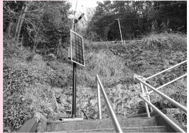
▲津波避難路への照明灯の設置を進めます
