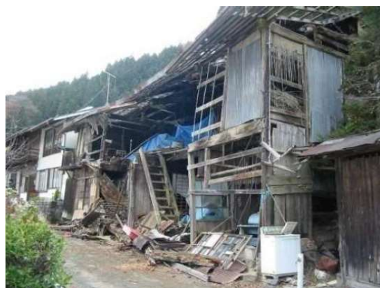
倒壊の恐れのある空き家
