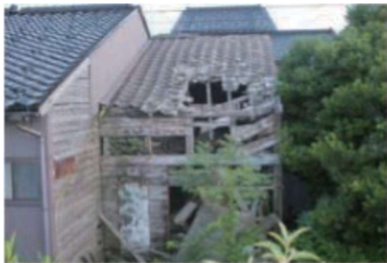
屋根が崩落した空家等
