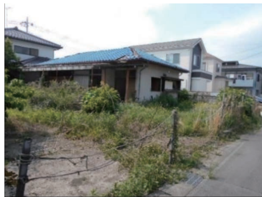
適切に管理されていない空き家等 雑草が繁茂、屋根の一部が欠損
