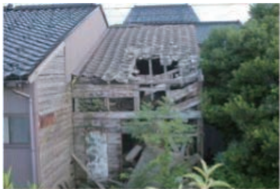
屋根が崩落した空家等
