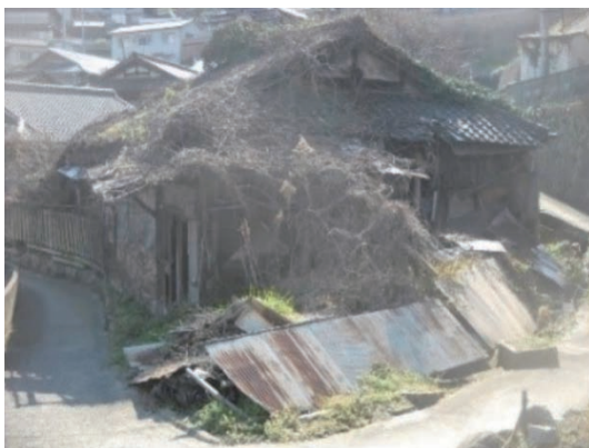
特定空き家等 老朽化が進み、倒壊等の危険性大
