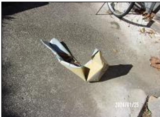
隣接地に落下した表層部材
