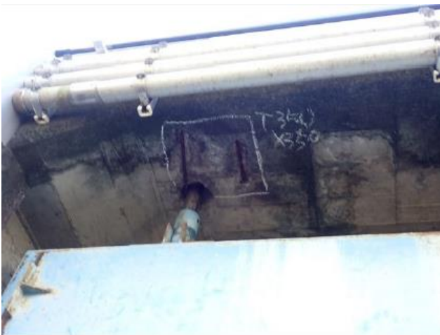
図- 2.3 ②-1 経年劣化(コンクリート) 中性化
