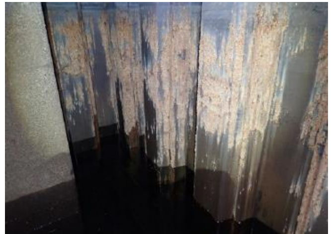
図- 2.4 ②-2 経年劣化(鋼材) 腐食
