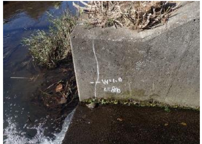
図- 2.2 ①-3 初期劣化(外力):不等沈下
