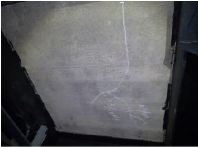
図- 2.1 ①-1 初期劣化:乾燥ひび割れ
