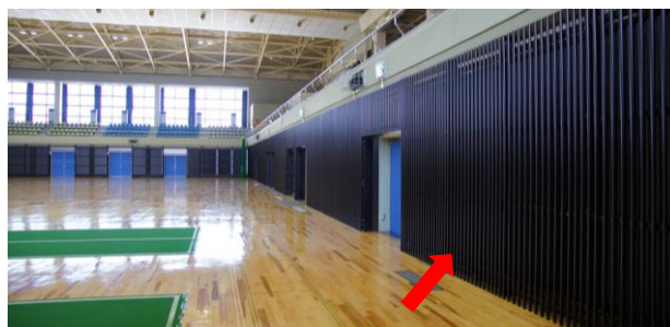
省エネ型空調設備の設置例（宇土市民体育館「輻射式冷暖房」）
