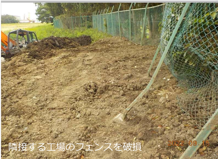
北側の農業用水路を破損
